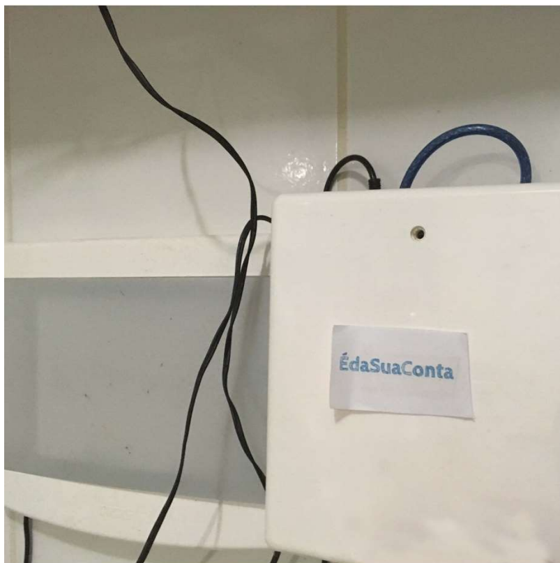
Figura 42: Protótipo instalado na residência.
