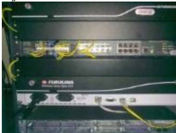
Figura 12 – Foto do switch core da sala de servidores
