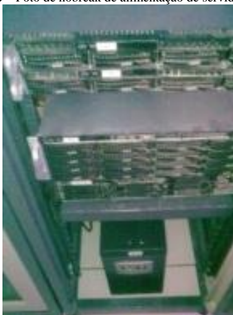
Figura 10 – Foto de nobreak de alimentação de servidores
