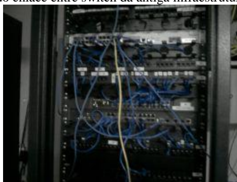
Figura 3 - Foto do enlace entre switch da antiga infraestrutura da UESB
