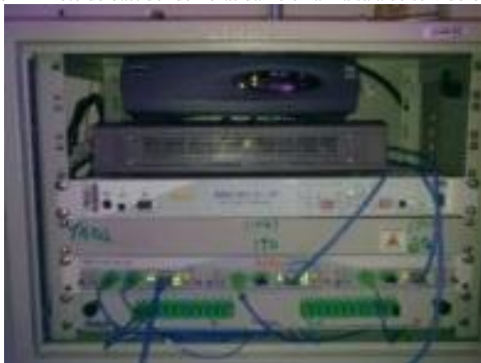
Figura 11 – Foto do bastidor de fibras da Telemar na sala de servidores
