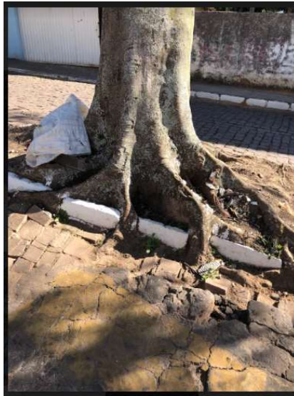
Figura 11. Espécie Delonix regia (Bojer ex Hook.) Raf., com raízes danificando pavimentações, na rua Rua Major Telesphoro Herminio Pereira Pereira Figure 11. Delonix regia (Bojer ex Hook.) Raf. species's roots damaging pavements, on Rua Major Telesphoro Herminio Pereira street
