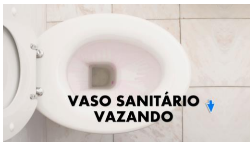
Figura 8 – Mini-caso Vaso Sanitário Vazando. .
