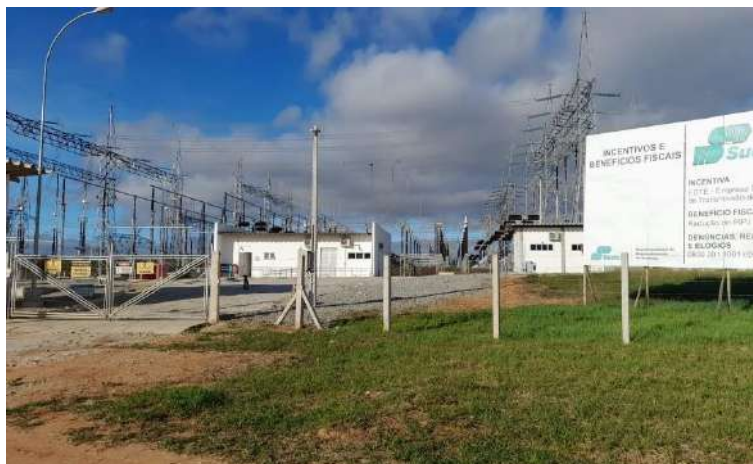
Figura 1 - Subestação de Distribuição de Energia Elétrica (Poçoões-BA)
