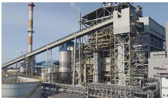
Figura 52 - Usina Termelétrica Itaqui (MA)
