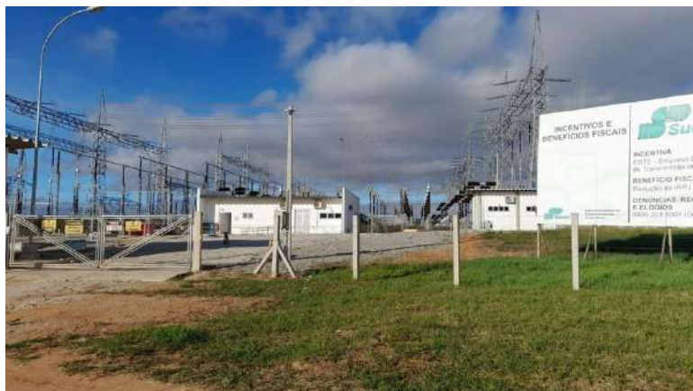
Figura 29 - Subestação de Energia Elétrica - Mediações do Município de Poções - BA
