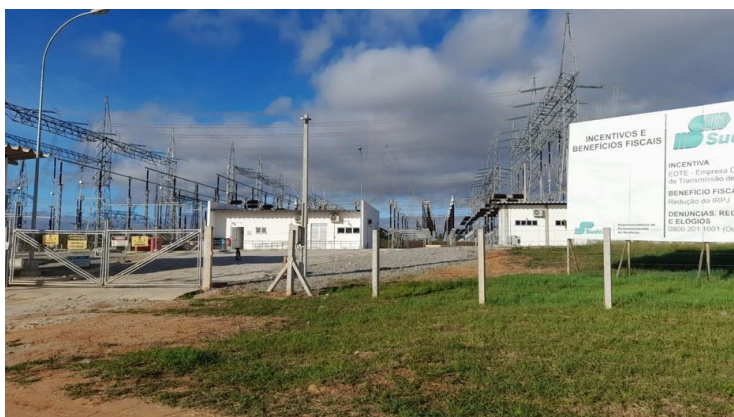
Figura 3 - Subestação de Energia Elétrica – Mediações do Município de Poções – BA
