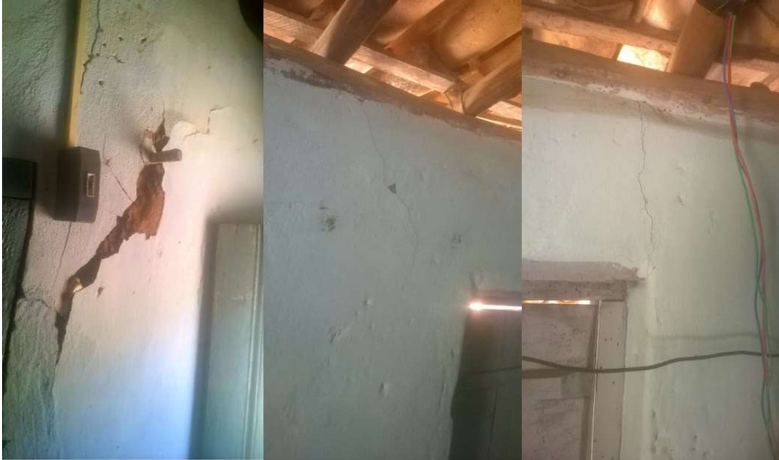
Figura 3 Rachaduras provocadas em residências próximas à Mina Pedra de Ferro após explosões
