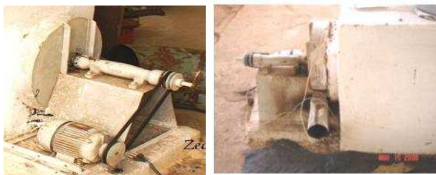
Figura 20 – Motor e saída de ar do sistema (Ch4).
