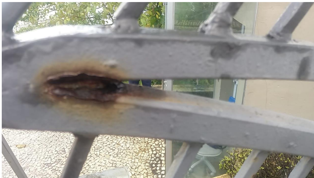
Figura 10 - Aparecimento de ferrugem.
