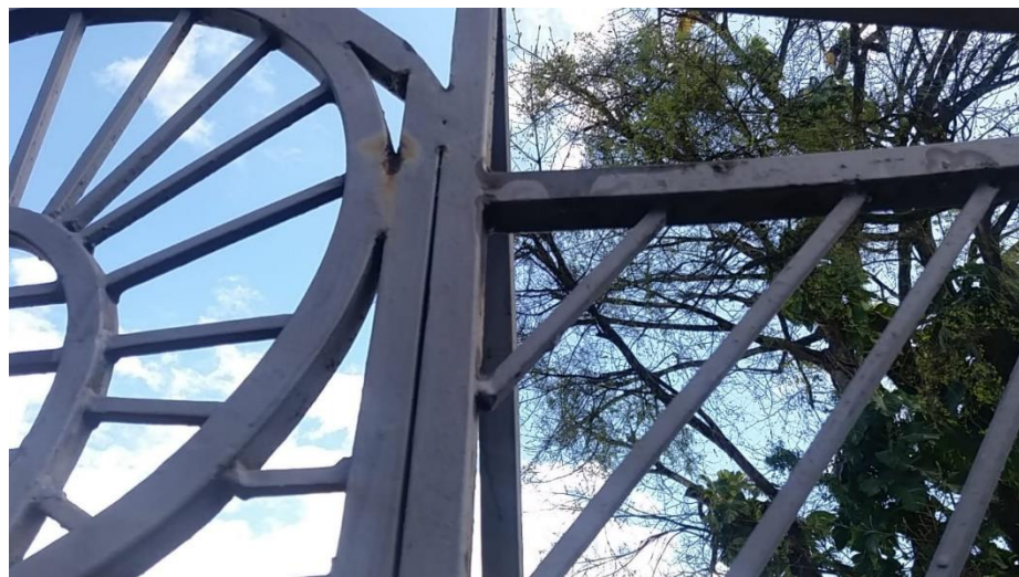
Figura 11 - Degradação do gradil.
