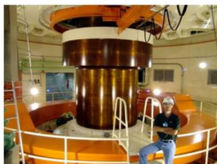
Gerador da usina de Itaipu
