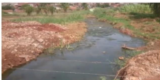
Rio São João (entulhos nas margens) - Bairro Prisco Viana
