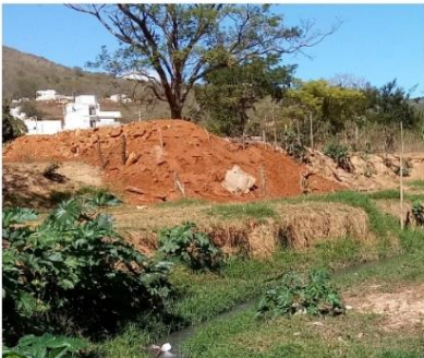
Entulho no leito para construção de ponte
