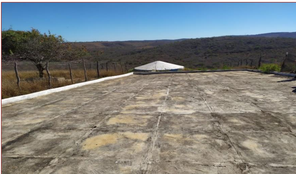
Figura 1 - Vista de uma cisterna calçadão na Faz. Bom Sucesso, Aracatu-BA/ Brasil (2019)
