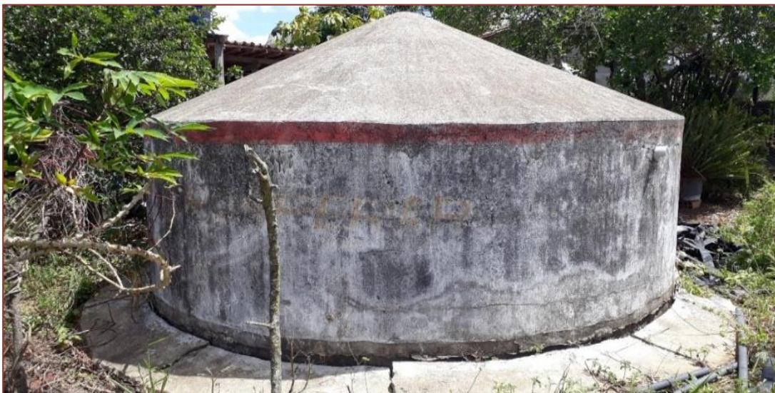
Figura 03 - Cisterna obtida via Projeto PROSPERAR.
