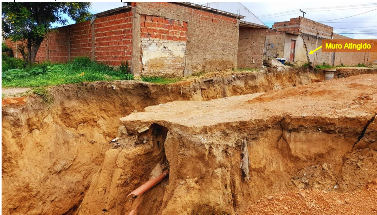
Figura 33 – Voçoroca localizada na área D, destrói muro na rua 18 do Loteamento Jardim Copacabana, Vitória da Conquista – BA - 2022
