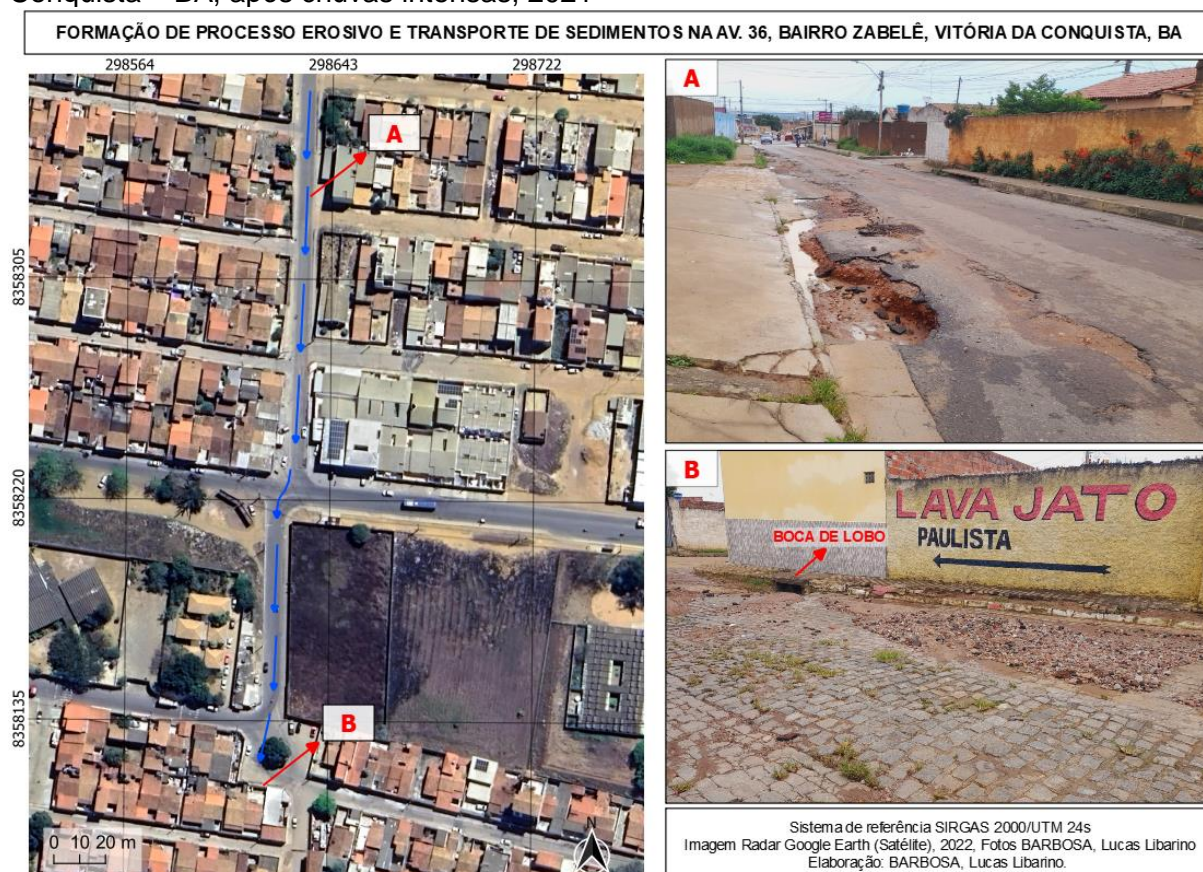
Figura 9 – Processo erosivo e transporte de sedimentos na Av. 36, bairro Zabelê, Vitória da Conquista – BA, após chuvas intensas, 2021
