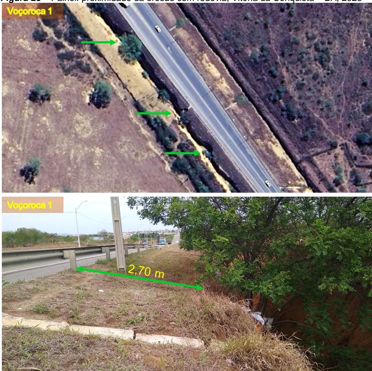
Figura 28 – Painel: proximidade da erosão com rodovia, Vitória da Conquista – BA, 2023
