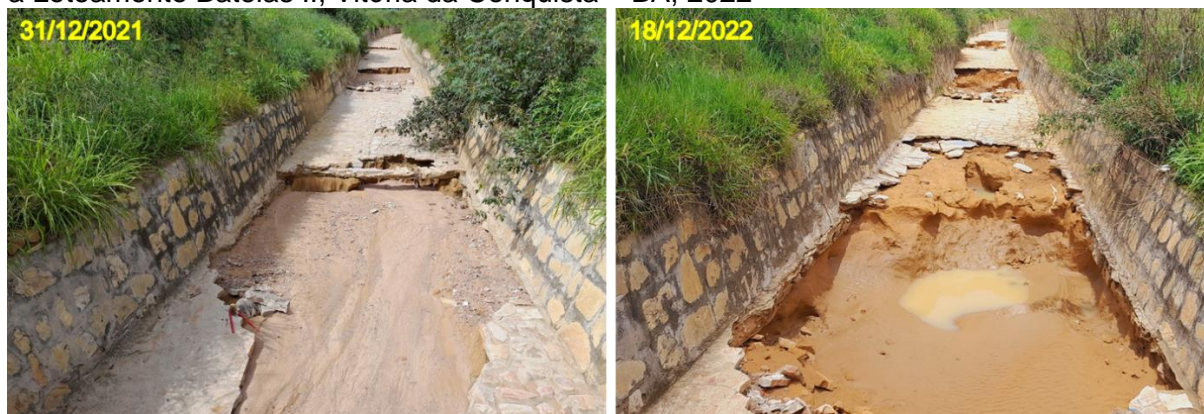
Figura 39 – Painel: evolução de processo erosivo em canal de drenagem na área L, próxima a Loteamento Bateias II, Vitória da Conquista – BA, 2022
