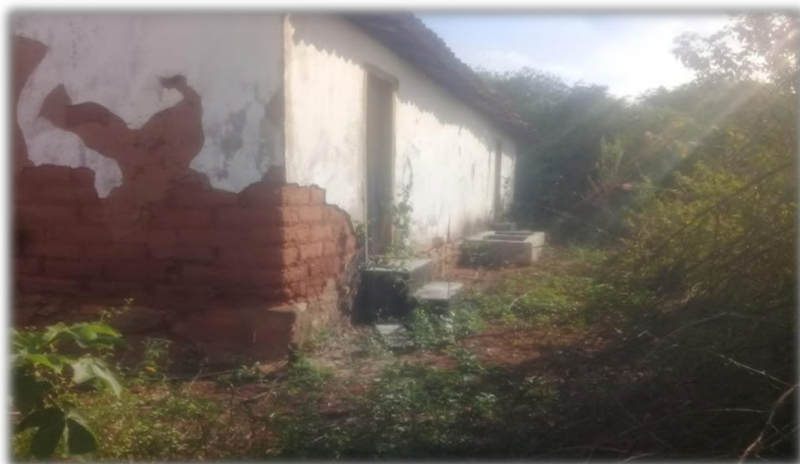
Figura 28- Casa de farinha em ruínas
