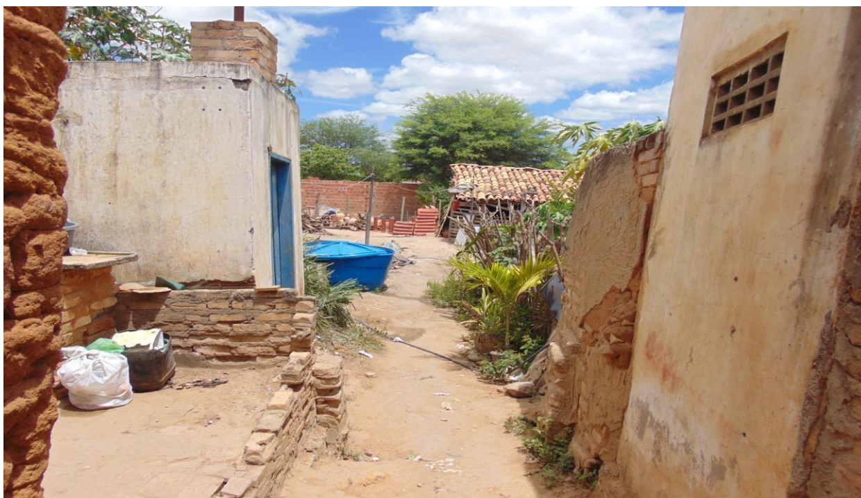
FOTO 9: Entrada de acesso ao quintal entre as casas de José e Edileuza Fonte: Acervo da autora
