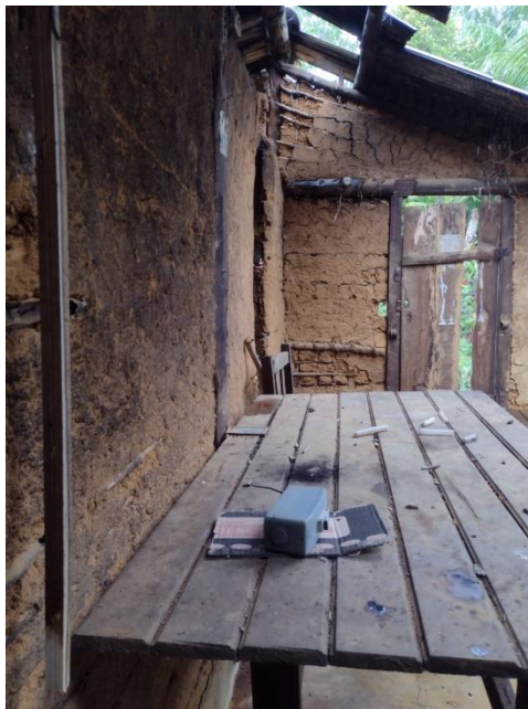
Casa abandonada na comunidade
