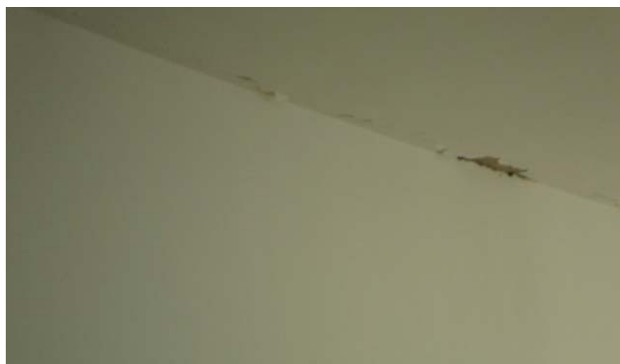
Figura 05 – Fissura no Laboratório de Melhoramento Animal
