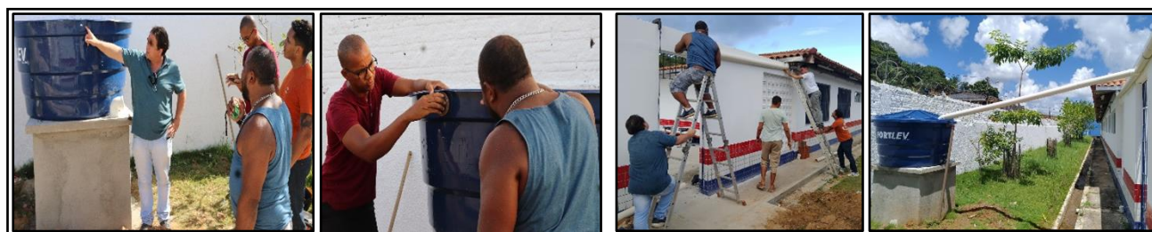
Figura 37. Instalação hidráulica do sistema de captação de água da chuva
