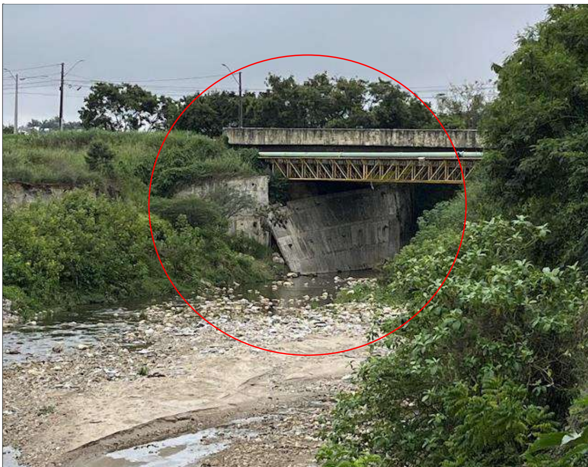
Figura 21 - Erosão na calha no Rio Verruga na ponte da Av. Luís Eduardo Magalhães
