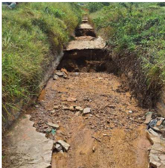
Canal de macrodrenagem no bairro Zabelê sem manutenção
