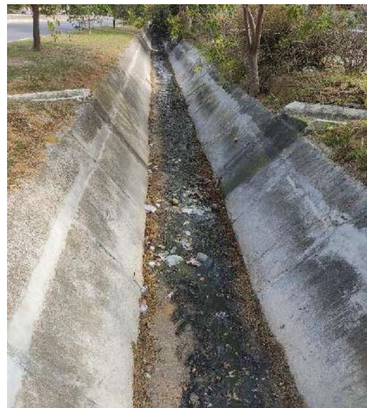
Lixo e esgoto depositado em canal de macrodrenagem da avenida Luís Eduardo Magalhães
