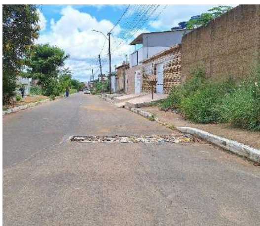
Lixo Acumulado em boca de lobo no bairro Zabelê
