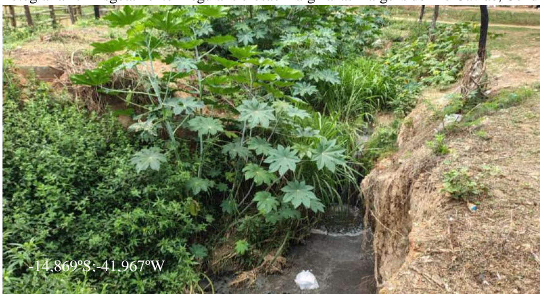
Fotografia 17 - Esgotamento irregular e erosão marginal as margens do Rio Gavião, Condeúba (BA).
