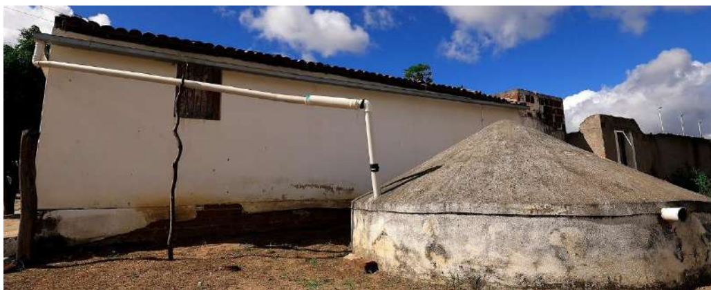
Figura 4 - Cisterna de 16 mil litros
