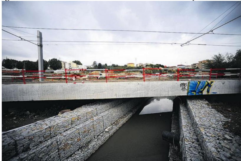
Figura 7 – Fotografia feita em 2012 durante as obras de instalação do metrô em Rio Tinto
