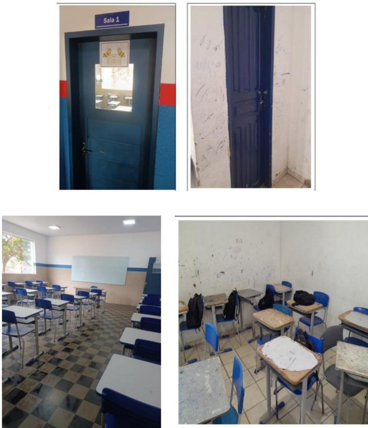
Figura 21 – Infraestrutura requerida (a esquerda) e a realidade objetiva (direita).
